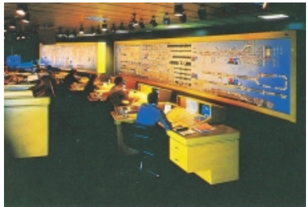
Vom Hauptbahnhof aus wird die ganze Tunnelstrecke der S-Bahn gesteuert
